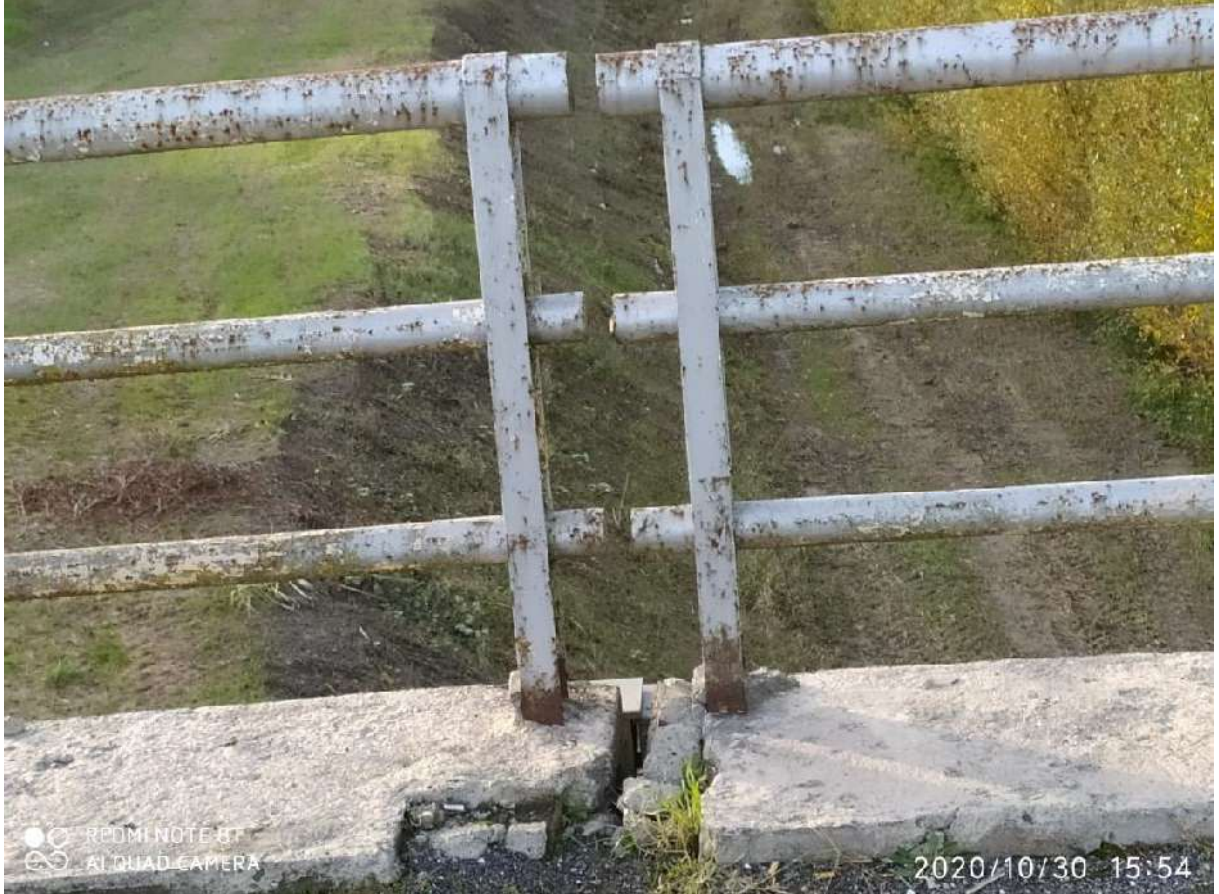
Abbassamento dell'impalcato e deterioramento guardiavia
