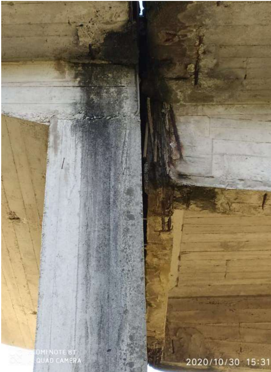
Ammaloramento trasverso d'estremità
